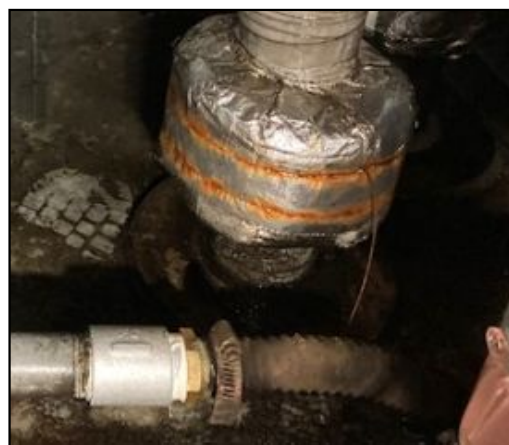
内部に発生した黒カビ
